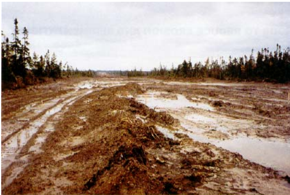
Zone défrichée de toute végétation – Avancement inapproprié des travaux
