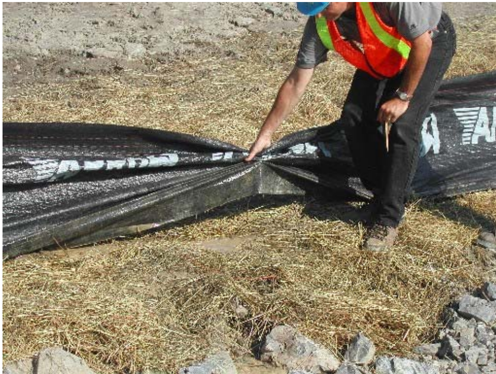
Installation inappropriée d'une barrière de retenue des sédiments
