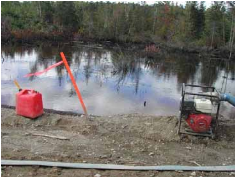
Produits pétroliers stockés trop près d'un cours d'eau.
