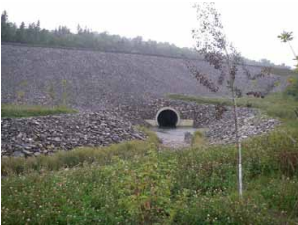
Stabilisation permanente du chantier, y compris la protection contre l'érosion des talus en remblai avant
