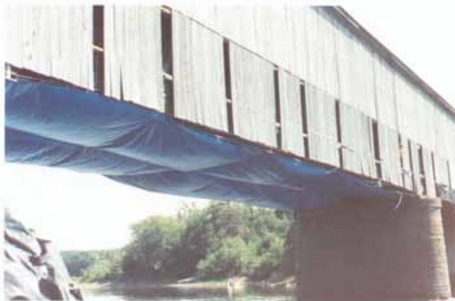
Cours d'eau adéquatement protégé pendant des travaux de revêtement en pierres concassées bitumées.
